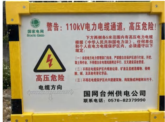
高压危险警示牌
