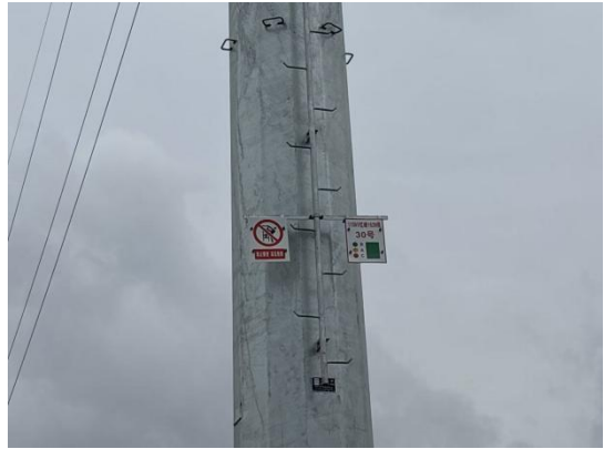
塔基警告标识
